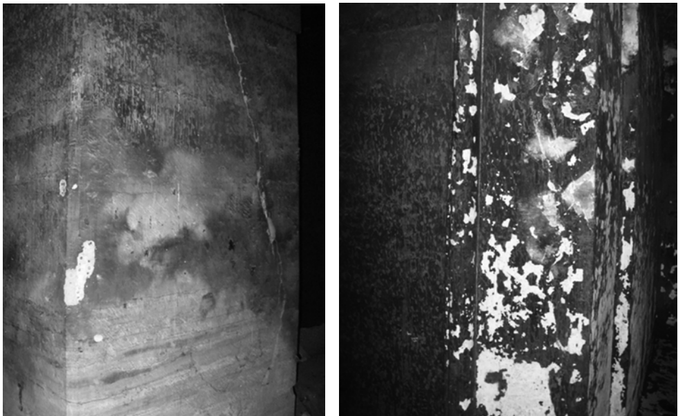
Fig. 4. (a) Detalle de columna afectada de forma desigual por el fuego. Obsérvese la ausencia de policromía en su superficie, donde se aprecia el veteado rojizo original de la arenisca. Fig. 4b Detalle de una jamba del nicho central y pared contigua. Nótese la superficie negra homogénea de la pared y el efecto que el fuego ha originado en la jamba, con exposición de la base blanca de la policromía, por el desprendimiento de las capas pictóricas superiores.
