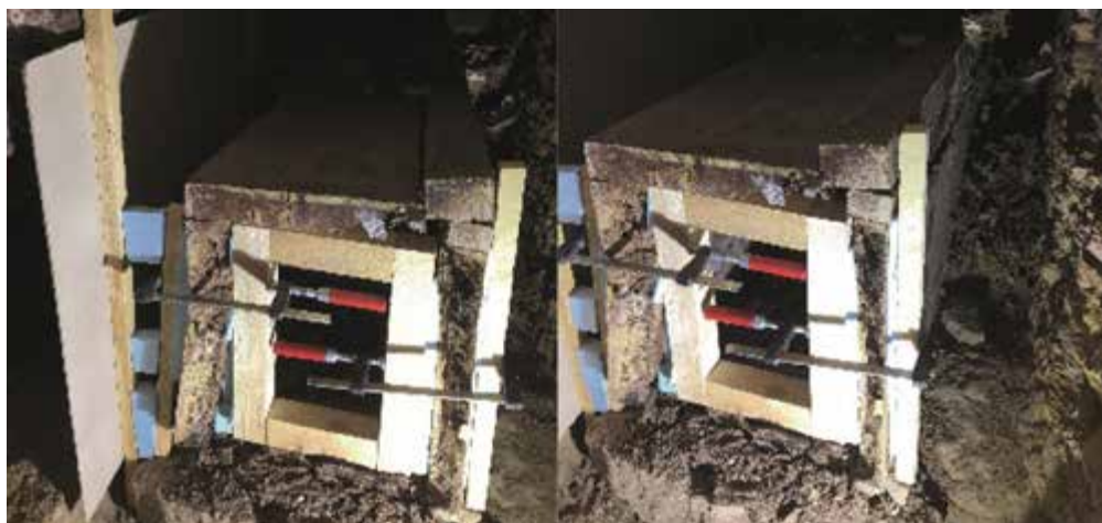
Figura 106. Estructura de protección desde distintos ángulos.
